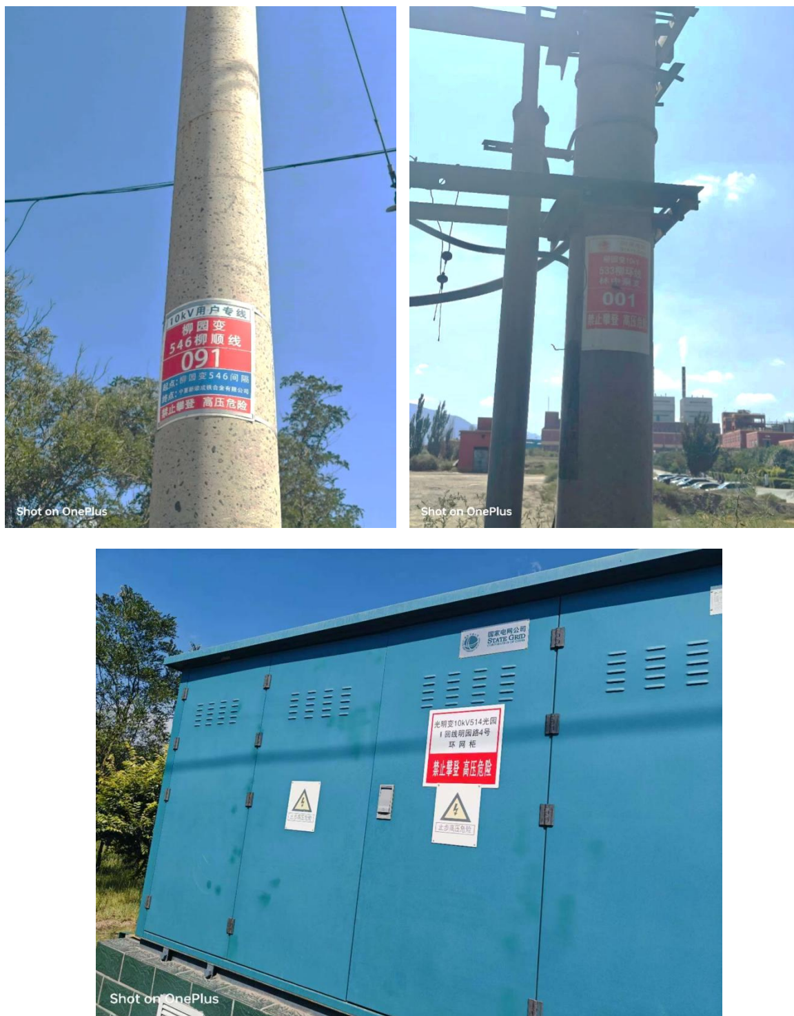
图 4-19 电力设施现场照片
